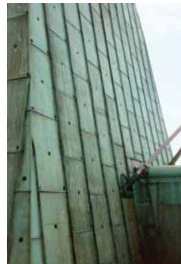
2. kép A szakszerűtlen „felújítási intézkedések” további károsodáshoz vezettek.
